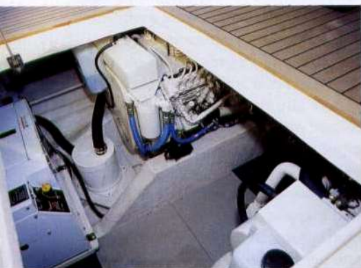
Una vista della sala motori, che ospita due Cummins da 370 cv ciascuno.
